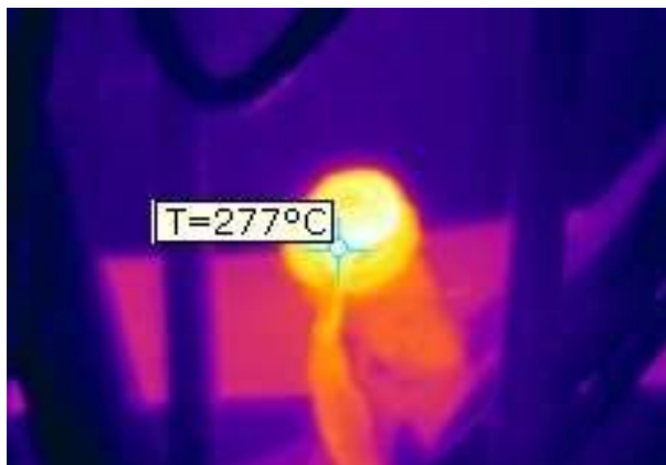
Рисунок 22. Пример обнаружения пожароопасного разогрева болтового контактного соединения
