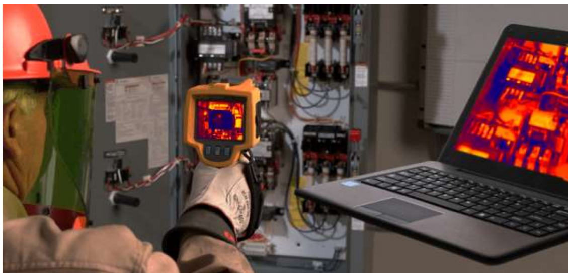
Рисунок 20. Пример проведения тепловизионного контроля электрошкафа
